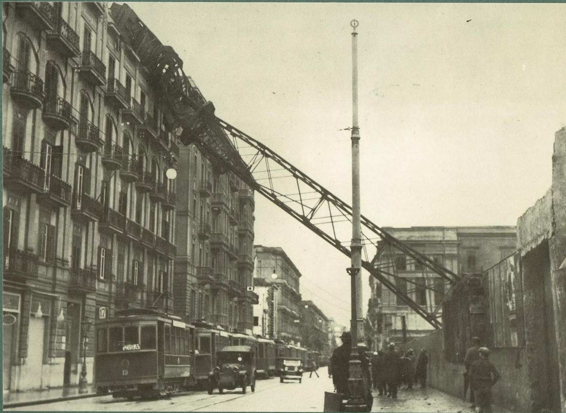
15 - La gru impiantata nel cantiere per la costruzione del nuovo Palazzo delle Poste, abbattuta dal vento, danneggiò l'ultima elevazione dell'edificio antistante.
